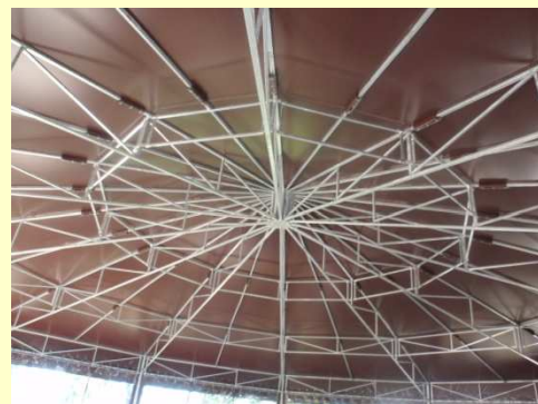
• Charpente métallique galvanisée à chaud
